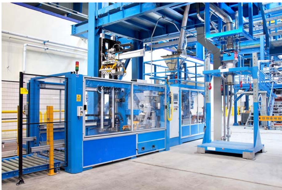
FFS Absack- und Palettieranlage IBP 250 von Coperion für die Produktion von Technischen Kunststoffen am BASF-Standort in Südkorea.
